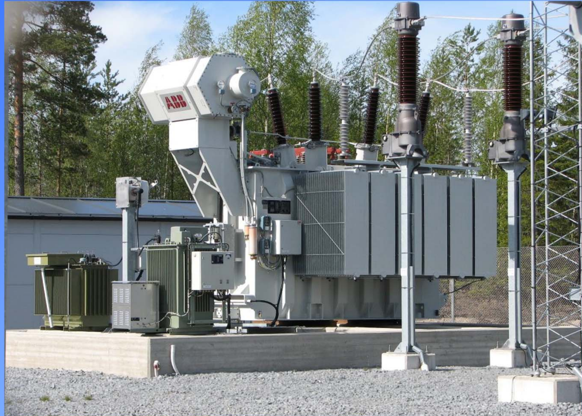
110 kV sähköaseman muuntaja
