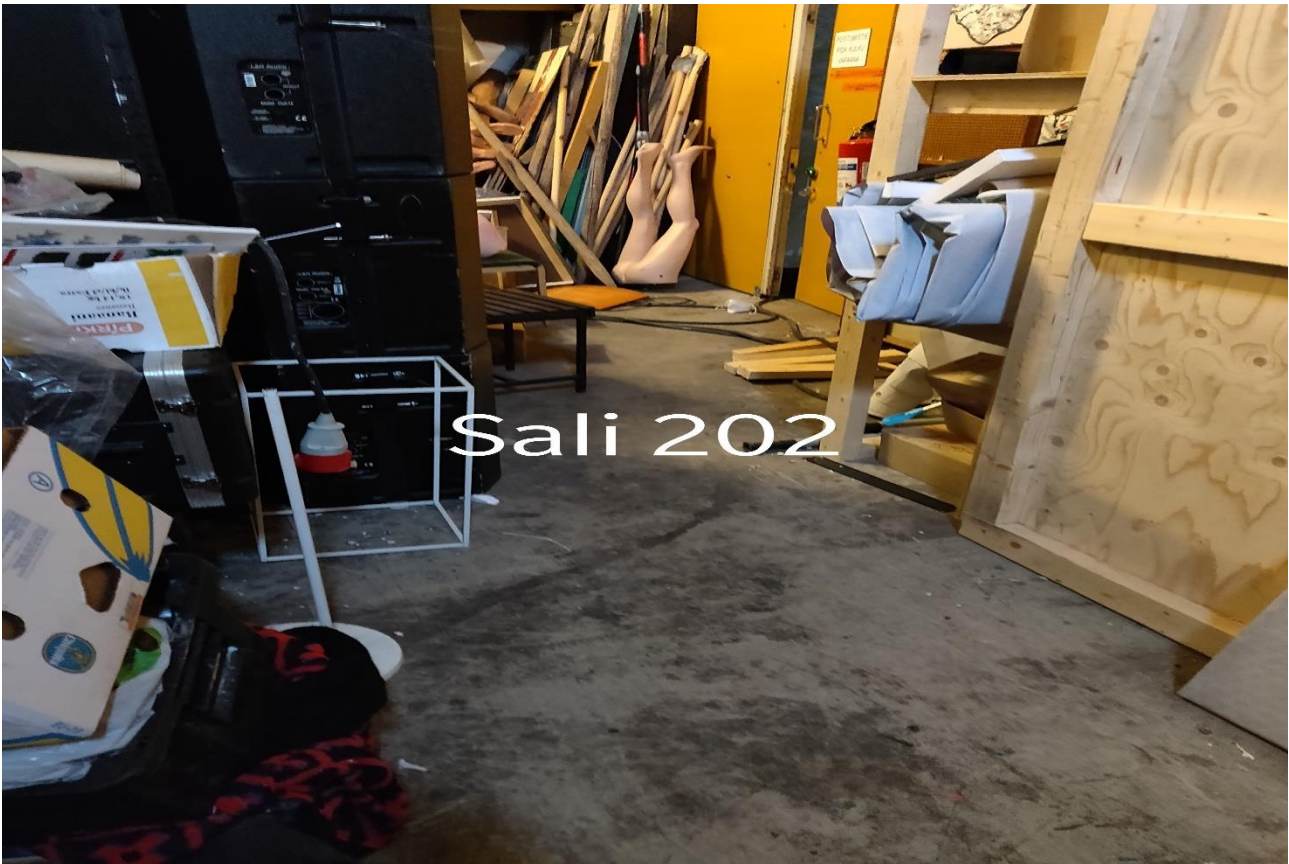
Sali 202, betonilattian pinnoitteena on käytetty muovimattoa, joka sisältää asbestia.
