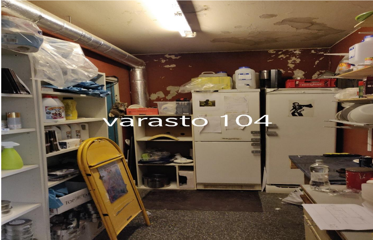
Varasto 104, seinien- ja katon maalien raskasmetallipitoisuudet ylittyvät. Punaisien maalien liijypitoisuus ylittää vaarallisen jätteen raja-arvot.
