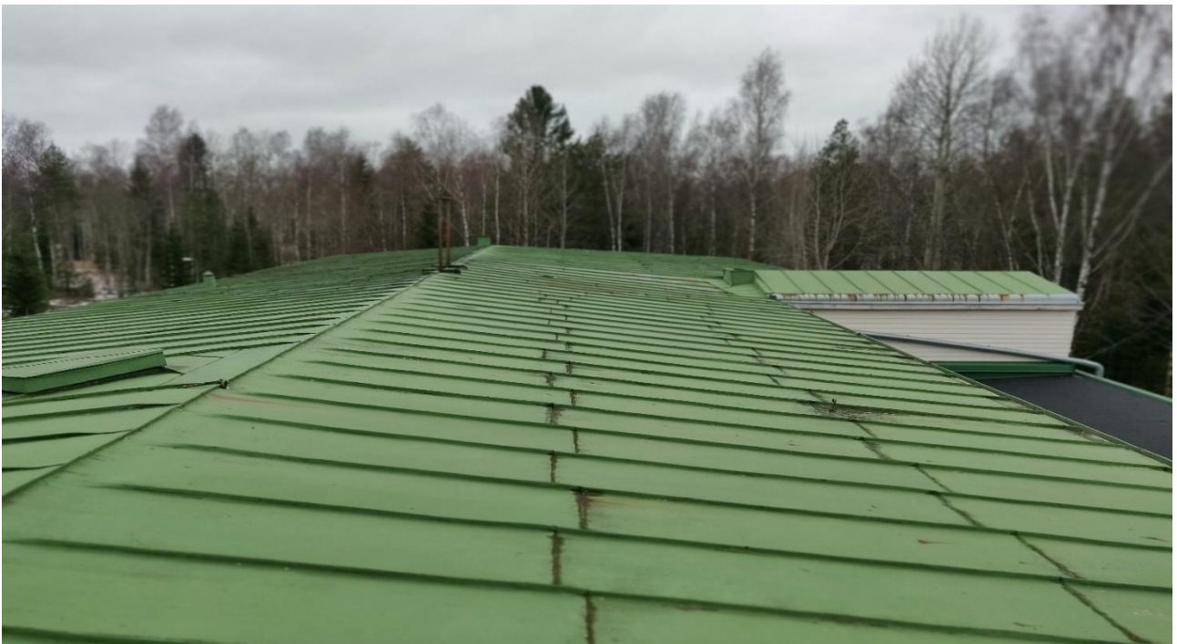
Rakennuksen vanhan peltikatteen maalien raskasmetallipitoisuudet ylittyvät. Katon maalien liijypitoisuus ylittää vaarallisen jätteen raja-arvot.
