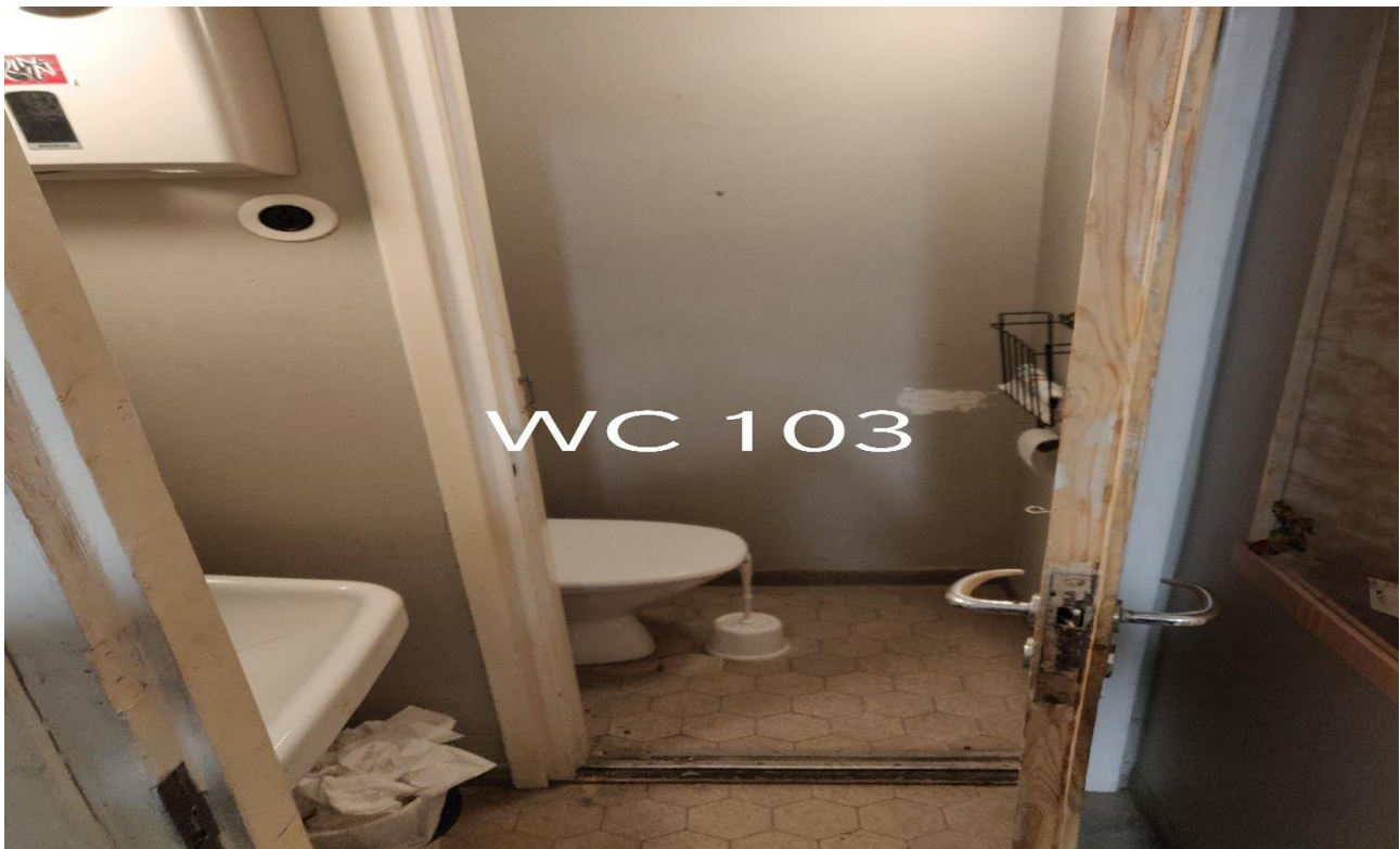
WC 103, seinien- ja katon maalien raskasmetallipitoisuudet ylittyvät.
