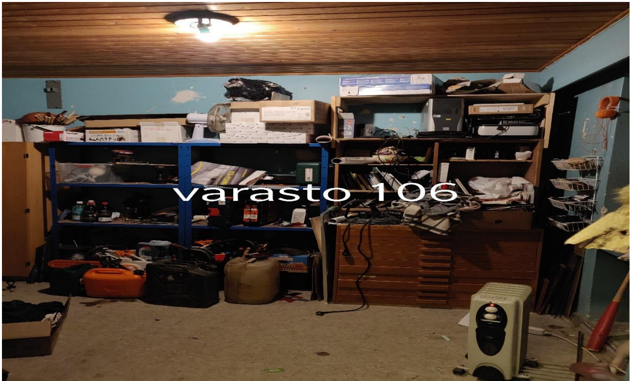
Varasto 106, seinien- ja katon maalien raskasmetallipitoisuudet ylittyvät.
