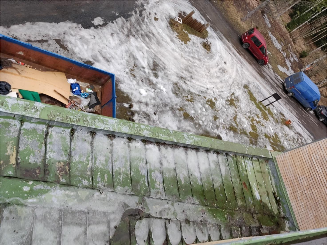
Rakennuksen vanhan peltikatteen maalien raskasmetallipitoisuudet ylittyvät.
