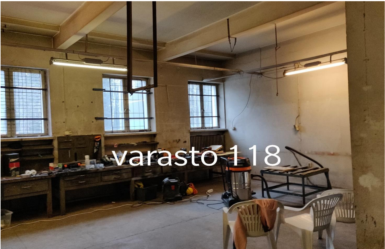
Varasto 118, seinien- ja katon maalien raskasmetallipitoisuudet ylittyvät.
