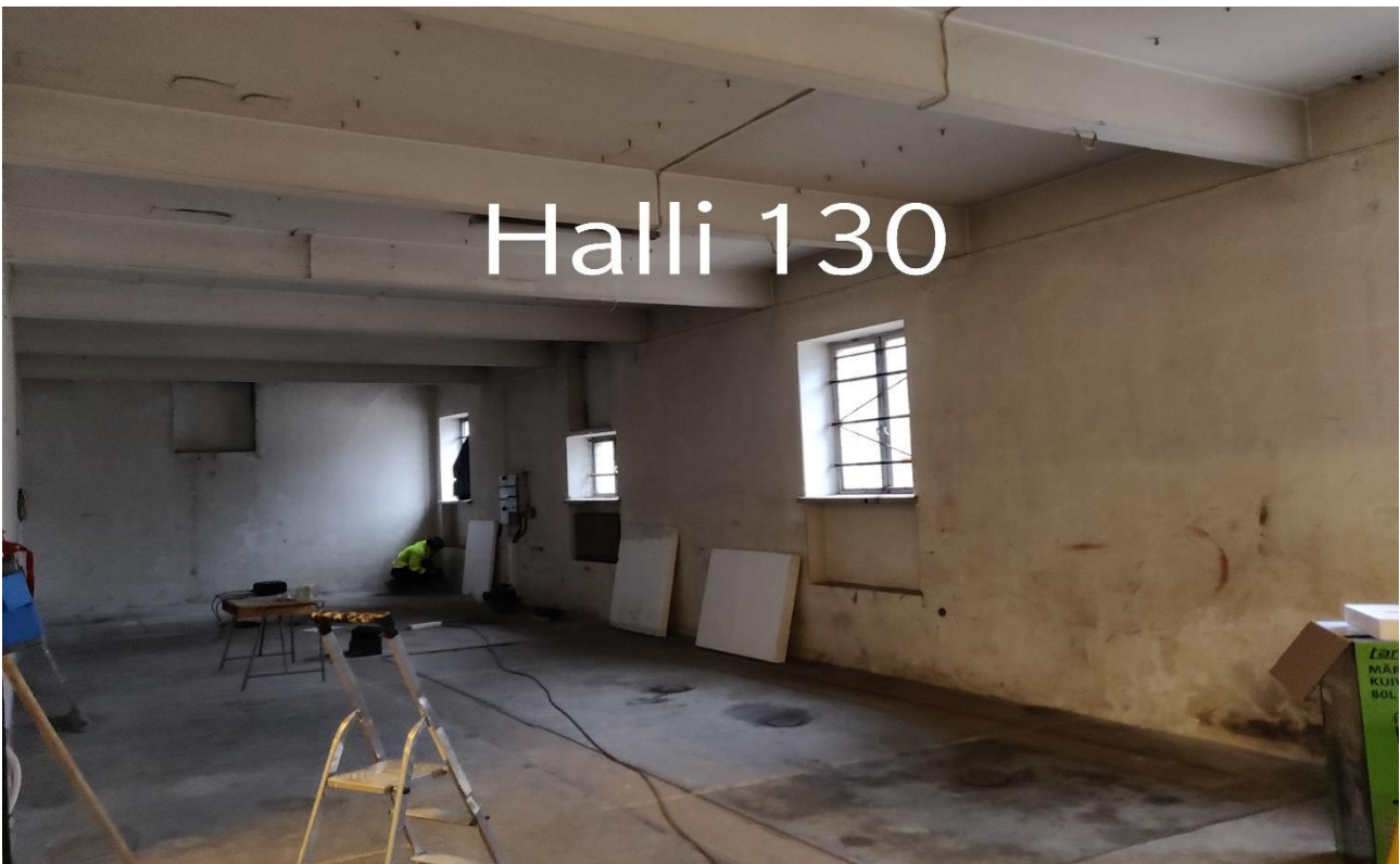
Halli 130, otettujen näytteiden perusteella seinien- ja katon maalien raskasmetallipitoisuudet eivät ylity.
