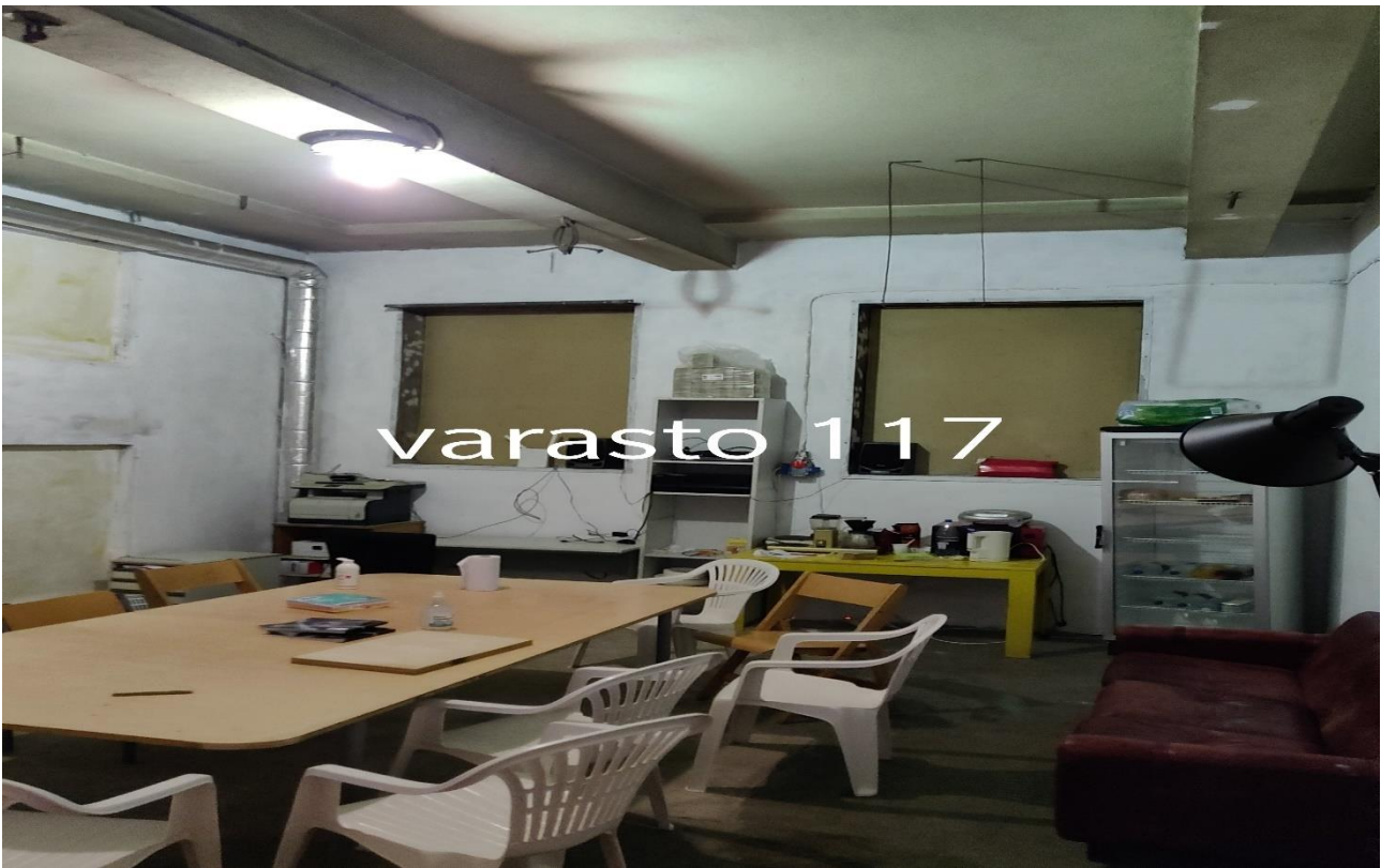
Varasto 117, seinien- ja katon maalien raskasmetallipitoisuudet ylittyvät.
