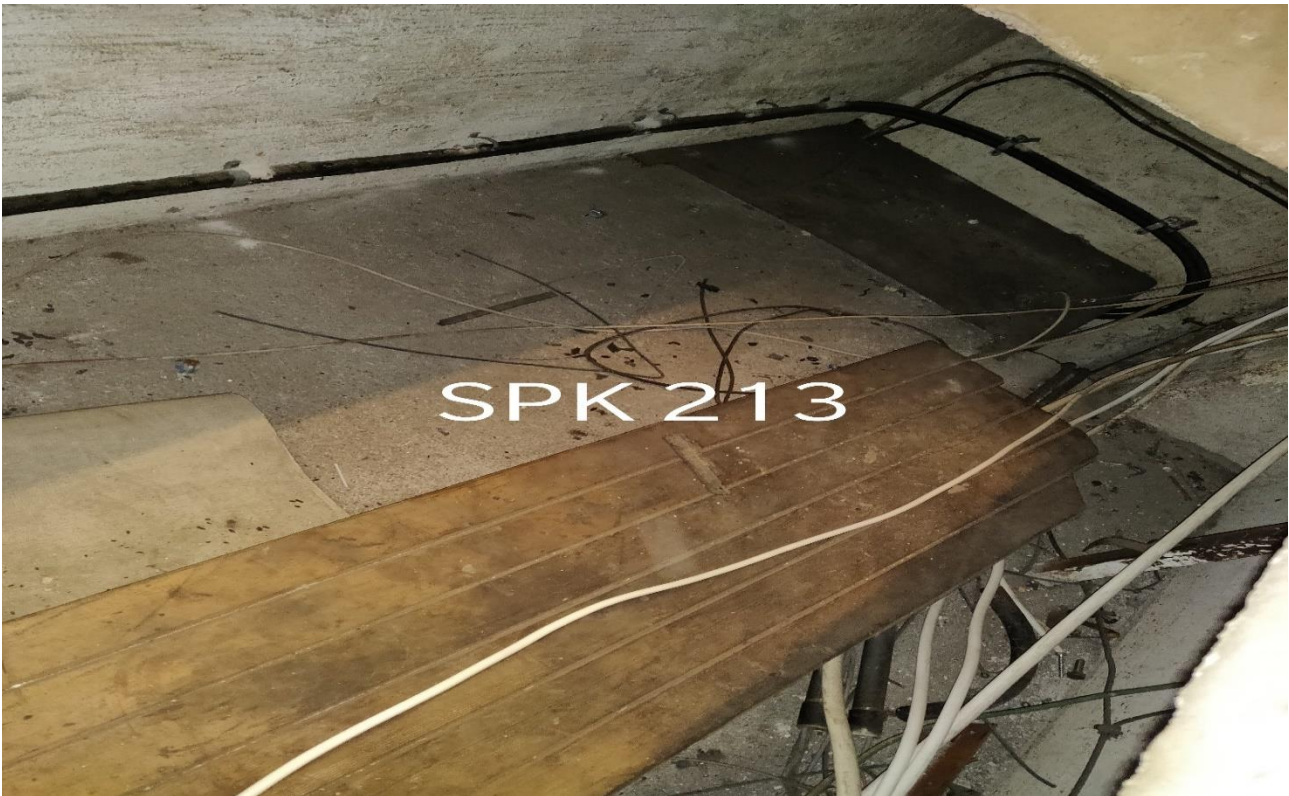
Sähköpääkeskus 213, lattian alla olevassa ontelotilassa kulkee osittain vanhoja pikieristeisiä sähköjohtoja.
