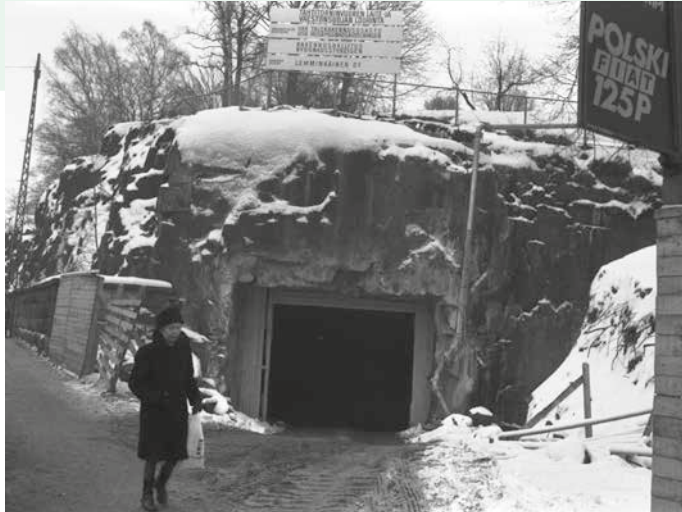
Tähtitornin vuoren laite- ja väestösuojaan louhintatyömaan suuaukko Laivasillankadulla. 1940-luvulla toteutettujen maanalaisten tilojen kulkuyhteys oli rakennettu Fabianinkadun päätyyn. 1970-luvun laajennustöiden yhteydessä louhittiin uusi kulkuyhteys Laivasillankadulle. Kuvaaja Simo Rista 1970, HKM.
