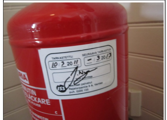
Käsisammuttimet tulee tarkistuttaa
