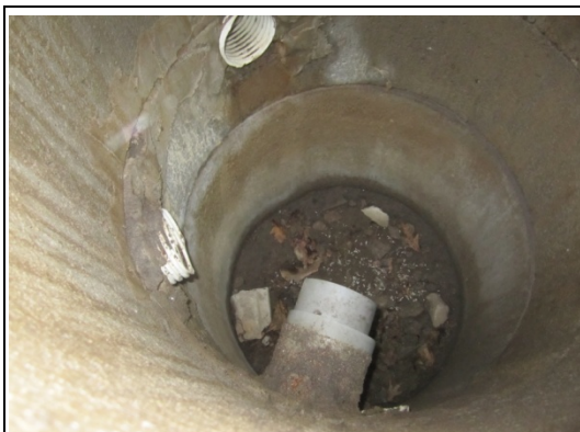
Salaojan tarkastuskaivo, purkuputki lähtee kaakkoon
