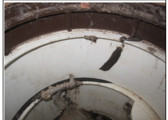
Lattiakaivossa useita korokerenkaita, tiiviste osittain irti
