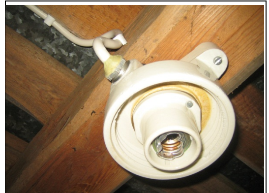
Rikkoutunut lampun kanta
