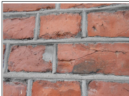
Tiilimuurauksessa halkeilua ja lohkeilua
