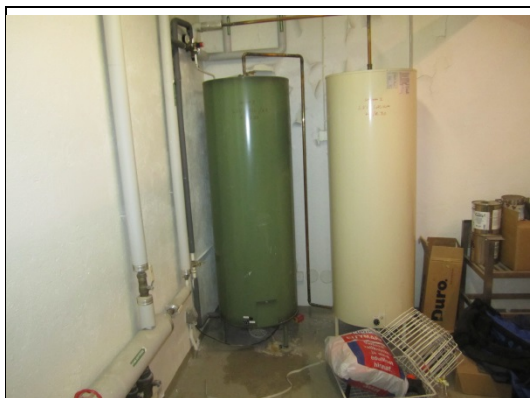
Saunan ja kellaritilan lämminvesivaraajat
