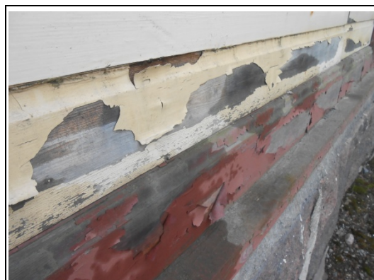
Maalikerroksen laajaa hilseilyä, lohkeilua alustasta
