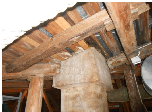
Vuotojälkiä läpivientien kohdalla
