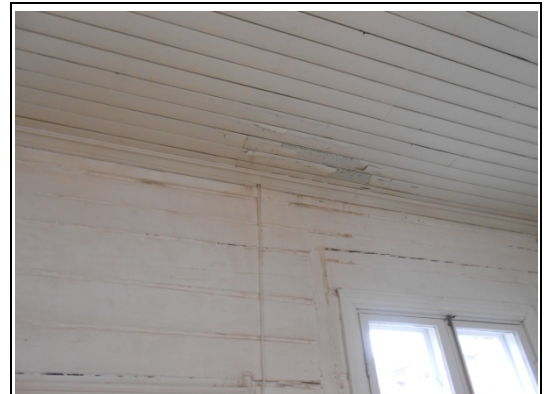
Ulkoseinän hirsirunko ja kosteusvauriojälkiä katossa
