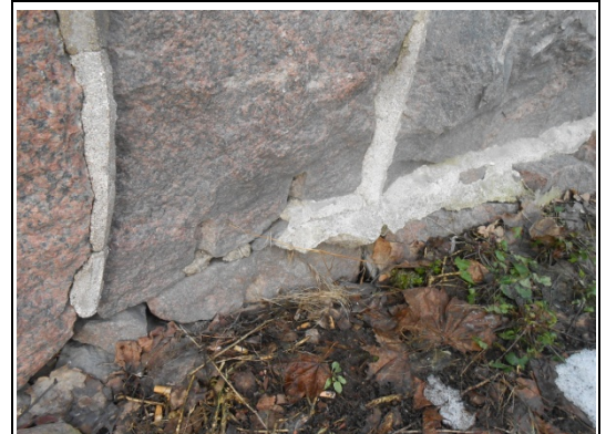
Kiilakivet irtoavat ja saumat paikoin vaurioituneet
