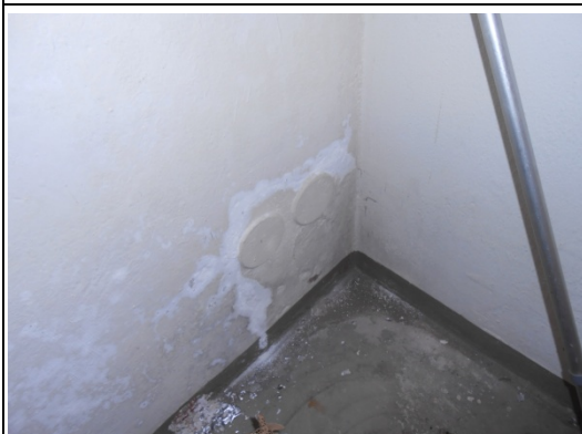
Kosteusvaurioita alapohjissa ja seinärakenteiden alaosissa
