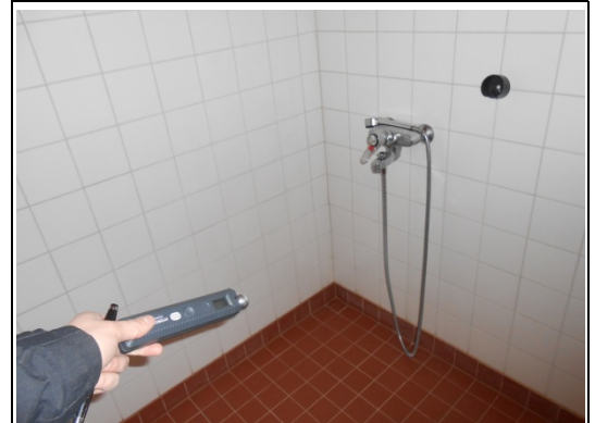
Alapohjassa kohonneita kosteuspitoisuuksia märkätilan kohdalla
