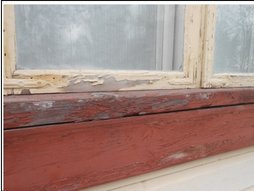
Maalivaurioita, haristumista, ikkunakittausten vaurioita
