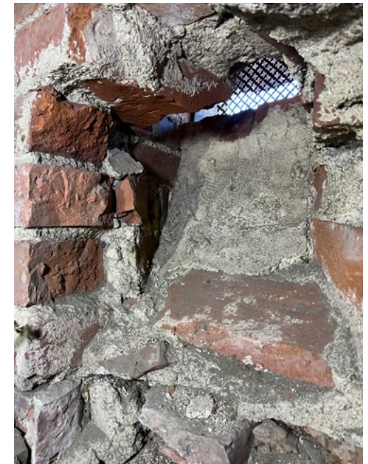
E) Tuloilmakanava sisältä ulospäin kuvattuna.
