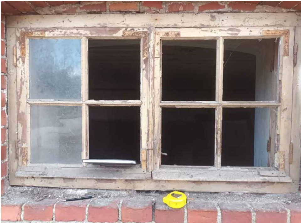
Ikkunatyyppi 1 ulkoa. Sisäpuitteiden lisäksi myös suuri osa ikkunalasesista puuttui. Puitteet oli vahvistettu ulkopuolelta kulmaraudoilla.
