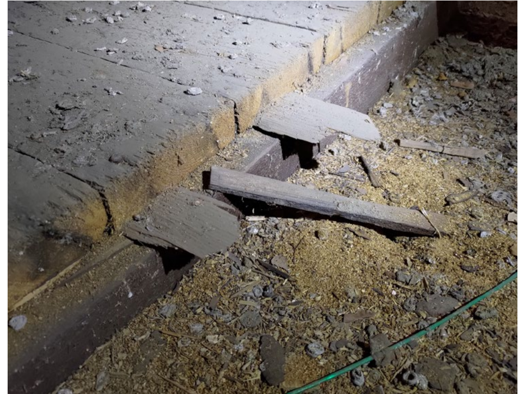
Välipohjan vaihtelevan levyiset lankut on naulattu kiinni parrujen yläpintaan. Välipohjan täytteenä on puupurua.
