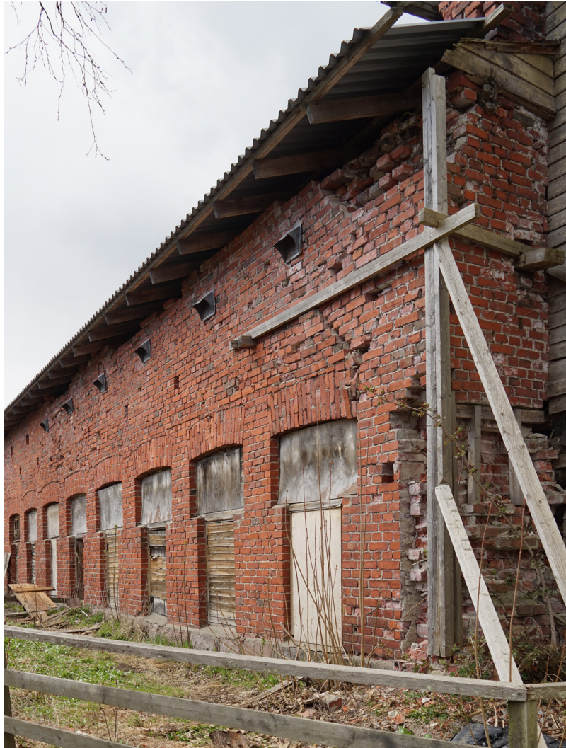
Kuva 7. Sinebryhoffin talousrakennuksen navetta-sikala -rakennuksen julkisivupääty koilliseen. (Mattila, 2022). Tiiliseinän koillisnurkka on osittain romahtanut.
