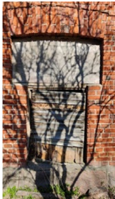
2. Pienäoven panelointi osittain irronnut
