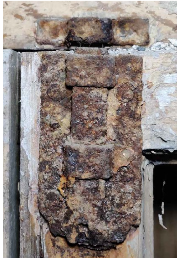
Ikkunan sisäpuiteiden yläosassa oleva ruosteinen kiväärisalpa.
