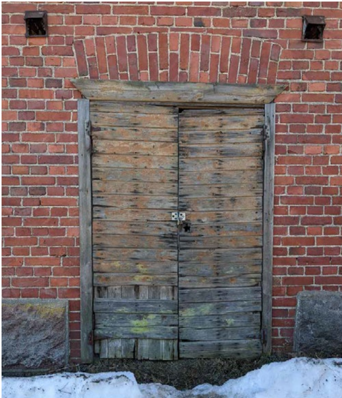
Oven alaosassa on tapahtunut vesivahinkoa ja osa paneeleista puuttuu.
