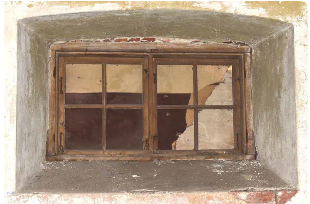
Ikkunatyyppi 1 sisältä. Sisäpuolen rappaus oli lohkeillut, minkä vuoksi pystyi havaitsemaan, että karmi oli viistetty seinän sisään päin.
