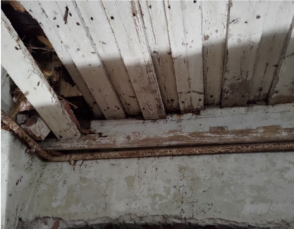
Navetan ja sikalan alakatot on alun perin verhottu valkoiseksi maalatulla lomalaudoituksella, jonka reunaa peittää muotoon sahattu kattolistasta. Navetan puolella alakatto ja listat ovat säilyneet, vaikkakin huonossa kunnossa.
