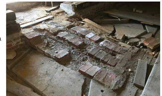
Kuva 31. Ramppi, joka johtaa korotetulle sisäänkäynnille on tiilistä rakennettu. Tiilet ovat kuluneet ja monta tiiltä on irronnut ja puuttuu.
