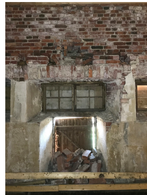
Kuva 10. Ulkoseinä navetan sisältä katsottuna. Sisäpuolen rappaus on osittain vaurioitunut. Suojatakseen sisätilan kosteudelta ja lialta, rappauksen alaosa on maalattu tummemmalla maalilla. Tummempi maali ylettyy ikkuna-aukkojen alareunaan asti. (2)
