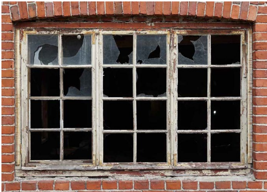
Ikkunatyyppe 2 ulkoa. Vaikka ikkunat näyttivät olevan huonossa, niin puu oli vielä kuitenkin kovaa ja ikkunat voisivat olla täysin kunnostettavissa. Kuva: Laura Mattila
