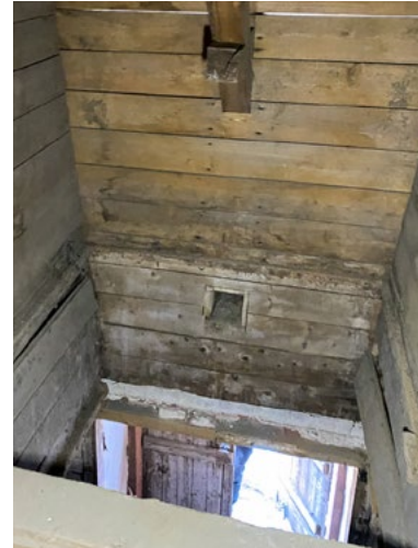
F) Tuloilmakanavan suu rehunpudotusaukossa.
