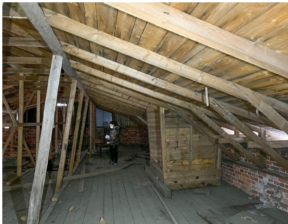
Välipohjassa on aukko navetan sisäänkäynnin kohdalla. Välipohjaparrut on jouduttu katkaisemaan aukon kohdalla. Katkaistut parrut on tuettu viereisiin parruihin tukihirrellä.
