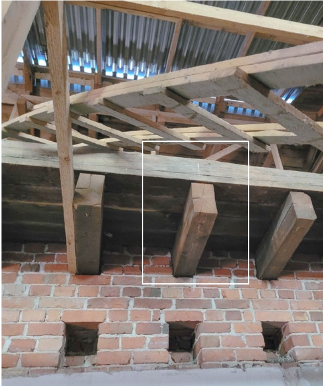
Navetan välipohjapalkkien päällä on rakennuksen pituussuuntainen parru, johon kattorakennetta tukevat vinosauvat ovat todennäköisesti tukeutuneet.
