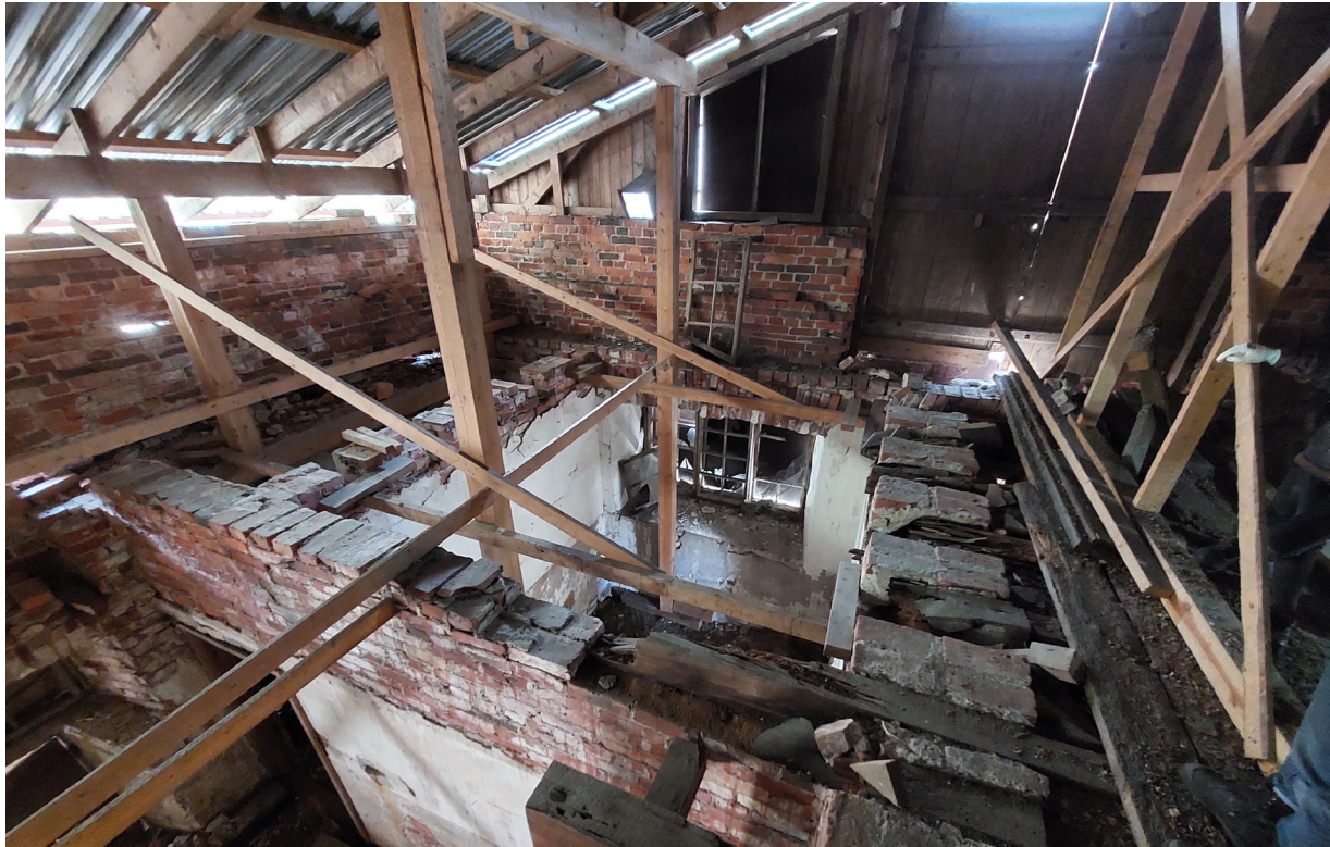
Kuva 17. Tiiliväliseinätyypit rakennuksen toiselta kerrokselta katsottuna. Valokuvan vasemmassa laidassa näkyy yhden kiven tiiliseinä (VS2, 290 mm) ja oikealla lähimmäisenä kahden kiven tiiliseinä (VS1, 580 mm). Seinien rappaukset ulottuvat eri korkeuksiin vaurioista riippuen. Rappauksen korkoon vaikuttaa myös sikalan matalampi huonekorkeus.
