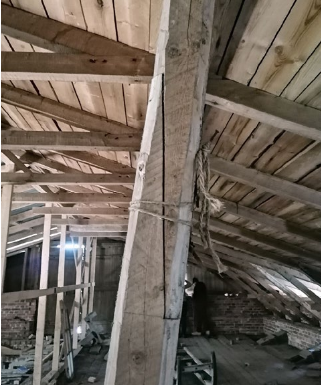
Tutkimuskohteessa joissakin tukisauvoissa on vino lapaliitos. Liitosta on vahvistettu narulla. Kuva: Laura Mattila.
