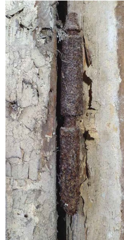
Ikkunan ruosteinen sarana
