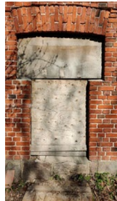
3. Ovet puuttuivat ja aukko paikattu vanerilla
