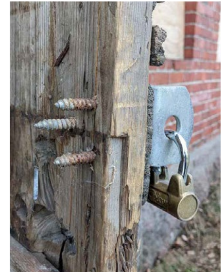
Salparautojen kiinnitysruuvit lävistävät ovilehden.
