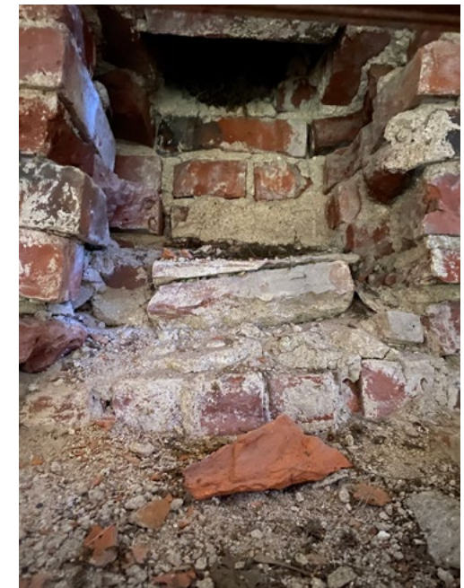
J) Tuloilmakanavan suu sikalan sisäpuolelta kuvattuna.
