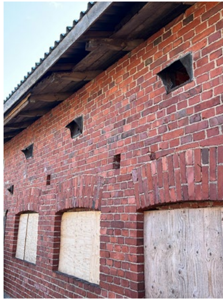
Q) Tuuletusrakojen kanavien suut sijaitsevat julkisivuissa tuloilmanavien alapuolella ja näyttävät samaan järjestelmään kuuluvalta.
