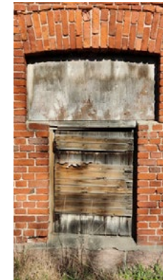
6. Oven panelointi osittain irronnut.
