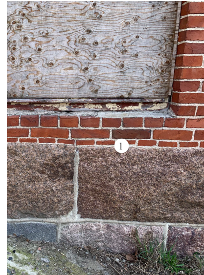
Kuva 26. Lähikuvassa rakennuksen lounaisjulkisivusta näkyy kivijalan ja tiilen liitoksen lisätyt noin puolen tiilen korkuiset tiilet, jotka on lisätty tasaamaan epätasaisuutta.
