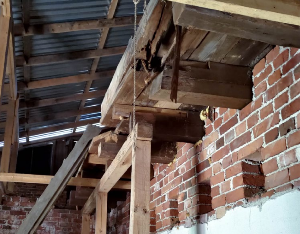
Kolme navetan välipohjaparruista näyttää olleen alusta asti vajaamittaisia, joten niitä on jatkettu lyhyillä lisäkappaleilla. Lisäkappaleet ovat osin irronneet.
