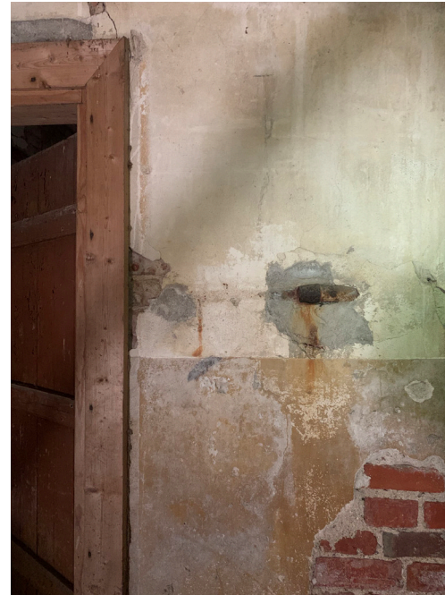
Kuva 15. Väliseinä sikalan puolelta katsottuna käytävän ovelelle päin. Tiiliseinän rappaus on osittain vaurioitunut. Rappauksen alaosa on samoin kuin toisessa tiilisessä väliseinätyypissä ja ulkoseinän sisäpuolella maalattu tummemmalla keltaokran sävyisellä maalilla. (1)
