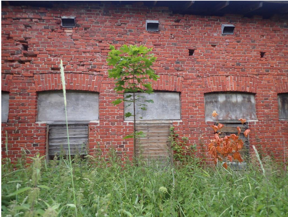
Kuva 21 Ulkorakennuksissa on runsaasti lepakoiden, ja miksei liito-oravankin, mentäviä aukkoja.
