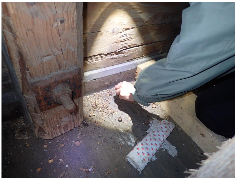
Kuva 17 Rakennustarkastuksissa etsittiin lepakoiden jätöksiä seinustojen vieressä. Kuvassa hiiren papanoita, pähkinänkuoria ja purua.
