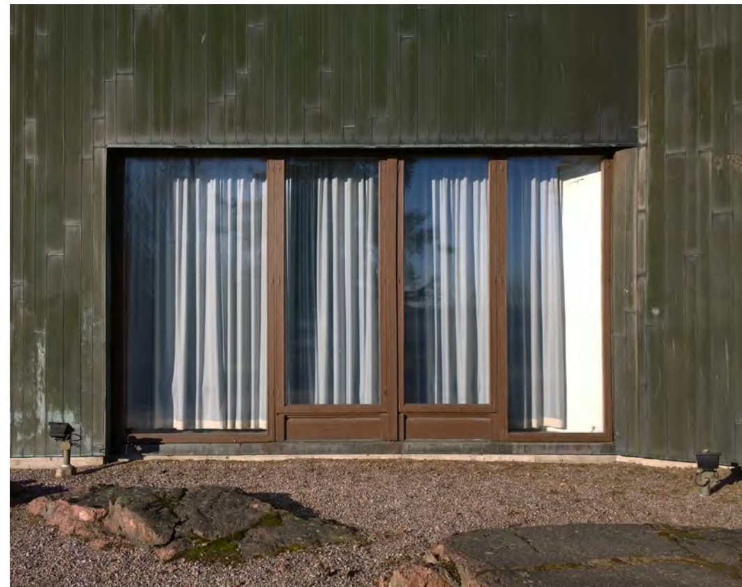
Esimerkki alkuperäisestä ikkunasta, joka on myöhemmin maalattu peittevästi.
