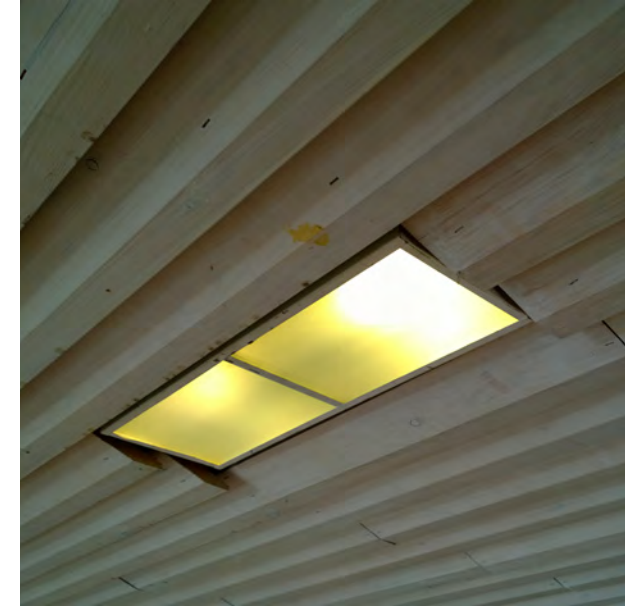
Yksinkertaisia metallilaatikkovalaisimia on pääportaassa, tuulikaapeissa ja monessa muussa paikassa.
