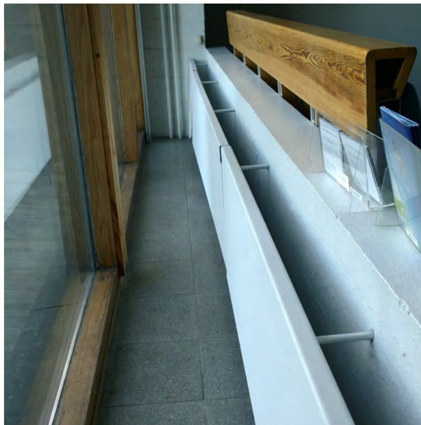
Patterikotelo teatterisalin takaosassa. Peltisuojat on nostettavissa pois.
