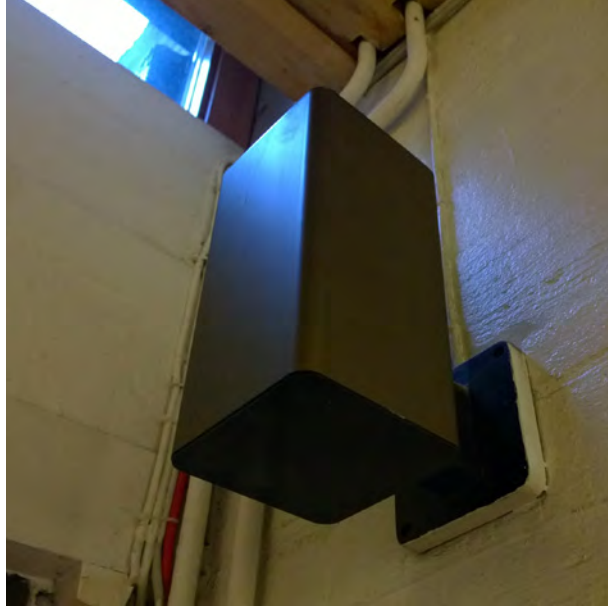
Ravintolahallissa ja Luolamiehen portaassa esiintyvä valaisintyyppi.
