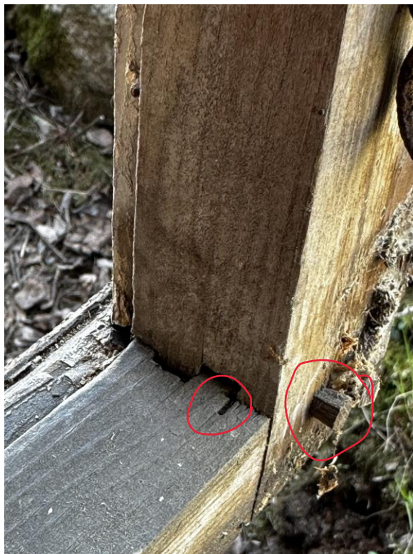
Sahauksen jättämät jäljet ikkunapuitteessa
