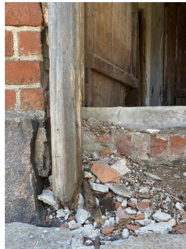
Oven karmin alaosa on kulunut, kynnystä ei ole ollenkaan.
