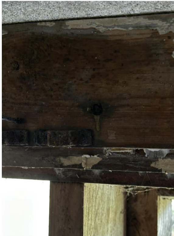
Viitteitä eristysteipistä ikkunan yläkarmissa
