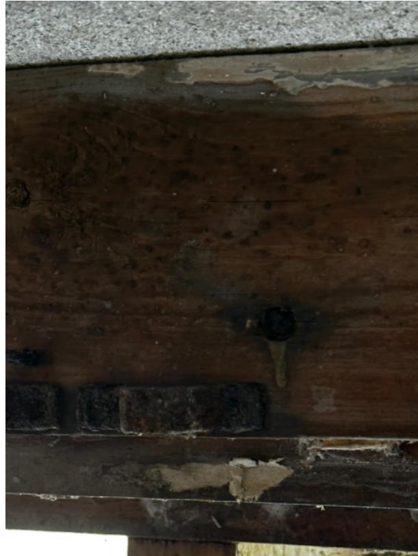
Ikkunakarmin sisäpuoleen kyntteessä nähtävissä viitteitä vaaleasta eristysteipistä.
