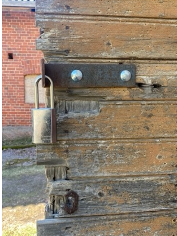
Ulko-oven vaakalaudoitus ja maalipinta on kulunut. Ovessa on uusi lukko.
