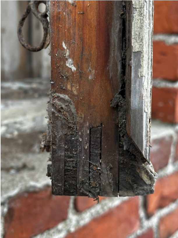
Viistetty profiloitu rakolista kiinnittyy alapuitteeseen jossa ei ole tyypillistä vesiuraa. Taka-alalla postipuuhun kiinnittyvät suljinhelat.
