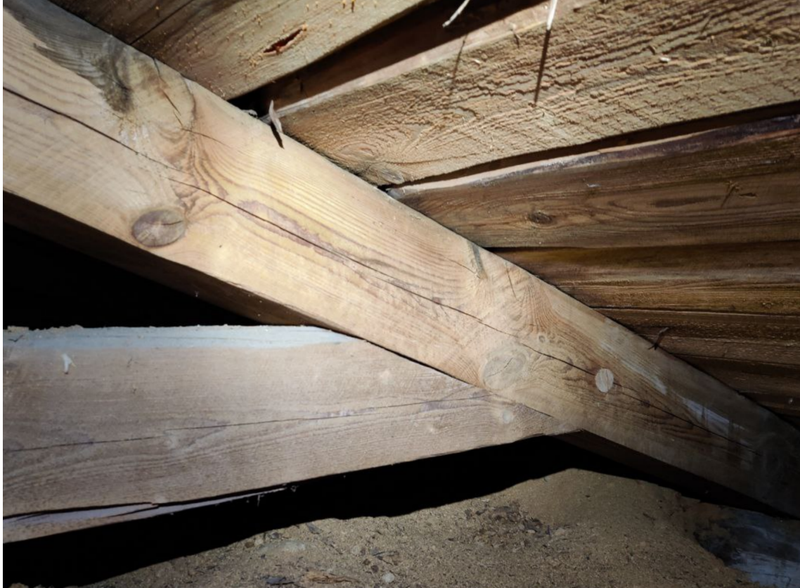
Kärpäpuun ja selkäpuun liitos on tehty hakaliitoksena ja vahvistettu puutapein. Kuva Sameli Sivonen.
