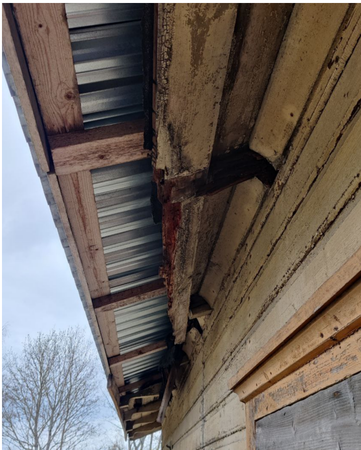
Lahonnutta räystästä. Kuva Sameli Sivonen.
