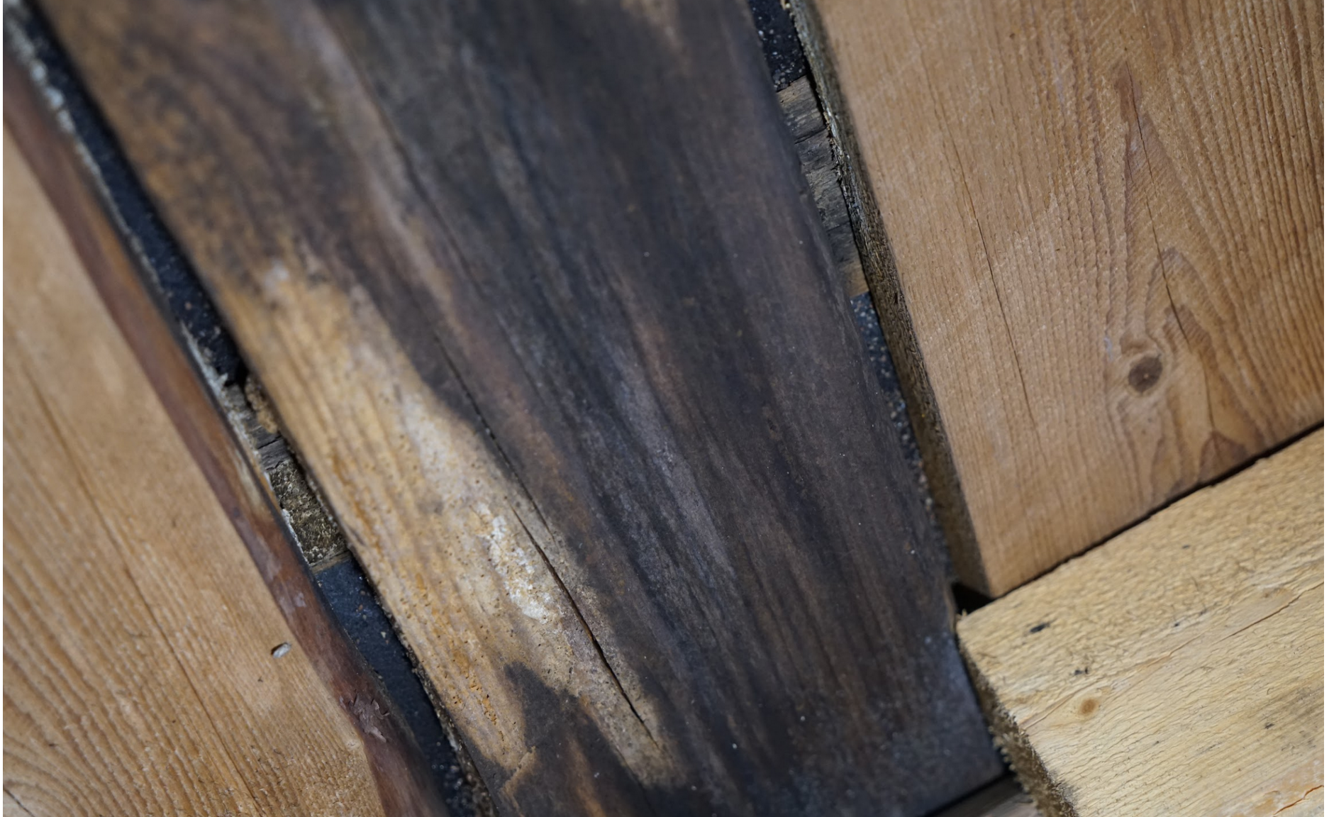
Kattolaudoitus sisäpuolelta nähtynä. Laudoituksen raoista näkyy kolmiorima sekä sen päällä oleva kattohuopa. Kuva Laura Mattila.
