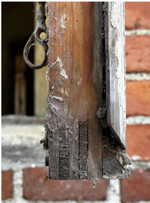
Vesiuraton ikkunalehti, sahauksen jäljet
