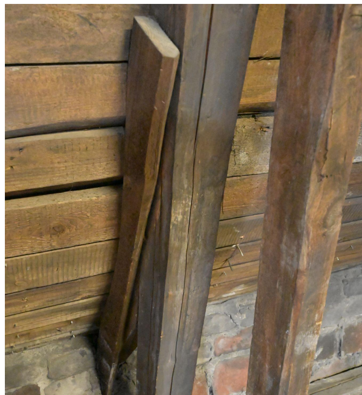
Selkäpuihin kiinnittävät ja ulkoseinän muuraukseen liittyvät laudat tukevat vesikaton lappeen kaareutuvaa muotoa.
