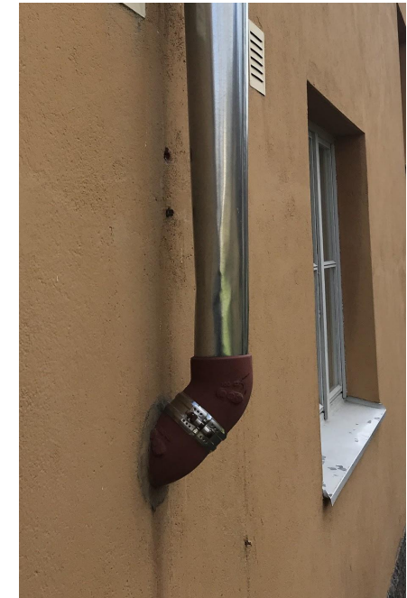
Pihan puolella syöksytorvet on muutettu ohjautumaan ulkoseinän läpi viemäriverkostoon. Alunperin hulevedet ovat valuneet maahan, kuten ne edelleen valuvat kadun puolella.
