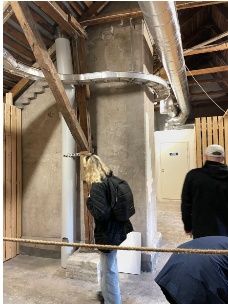
Hauhontie 8 E ja 8 F rappujen välissä sijaitsevan piipun läpivienti eristetyn yläpohjan kohdalla.
