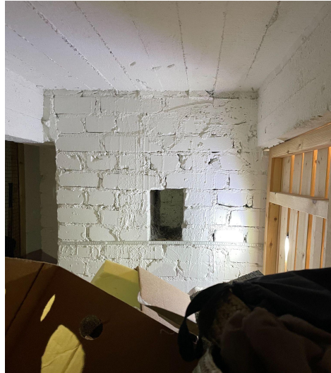
Kellarin poistoilmahormi ilman säädettävää venttiiliä. Hauhontie 6.
