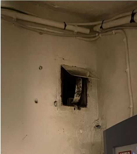
Kellarin poistoilmaventtiili. Hauhontie 4.
