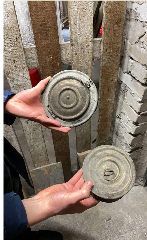
Vanhan kaakeliuunin poistoilmaventtiili ja nuohousluukku.
