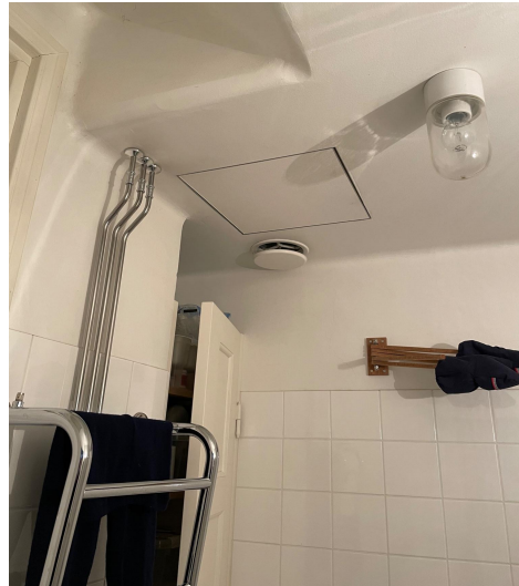
Kylpyhuoneen poistoilmaventtiili on katossa. Tästä voidaan päätellä, että siitä on tehty vaakaveto poistoilmahormiin. Painovoimaisessa ilmanvaihdossa voidaan tehdä pieniä vaakavetoja ilmanvaihdon siitä häiriintymättä. Hauhontie 8 F 33.
