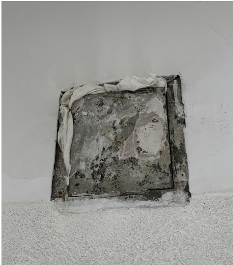
Asuinhuoneen vanhanmallinen korvausilman kippiventtiili. Vanha venttiili vaatii asukkaalta aktiivisuutta ilmanvaihdon säädössä: luukkua tulee avata ja sulkea ulkolämpötilan mukaan. Kuvassa venttiili on tukittu. Hauhontie 4 G 41.
