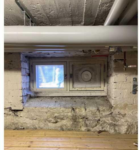
Kellarin korvausilmaventtiili. Hauhontie 6.
