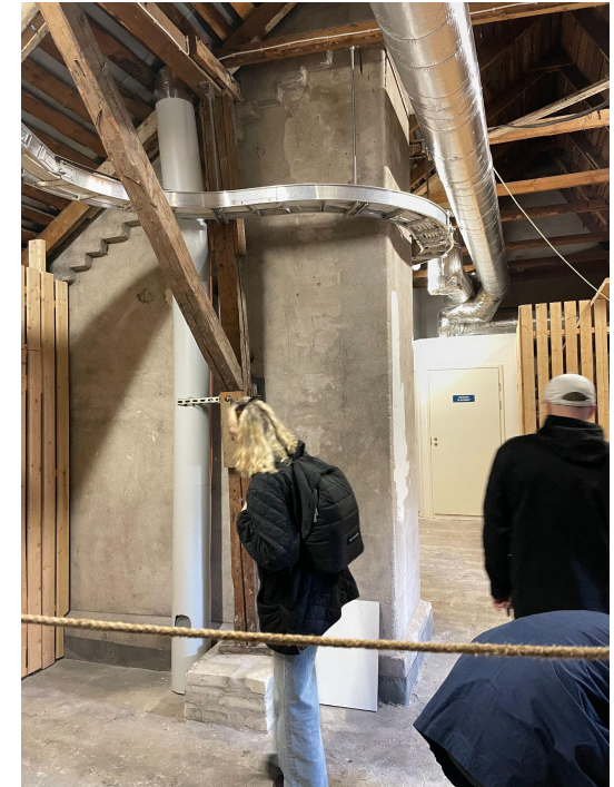
Taloyhtiön saunaosaston poistoilmakanava ullakolla. Saunaosastojen koneellinen ilmanvaihto on moderni, irrallinen lisä rakennusten ilmanvaihtoon.
