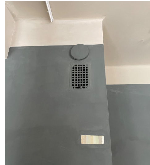
Maantasokerroksen liiketilan poistoilmaventtiili. Hauhontie 6 B.
