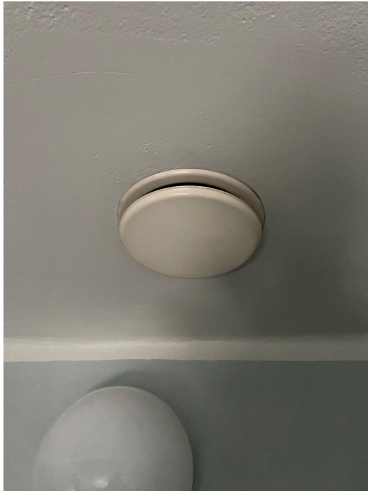
Porrashuoneen ylätasanteen poistoilmaventtiili. Ullakolle johdetut venttiilit on lisätty vuoden 1995 peruskuntoarvion jälkeen (Tuhkanen 1995: 2.)
