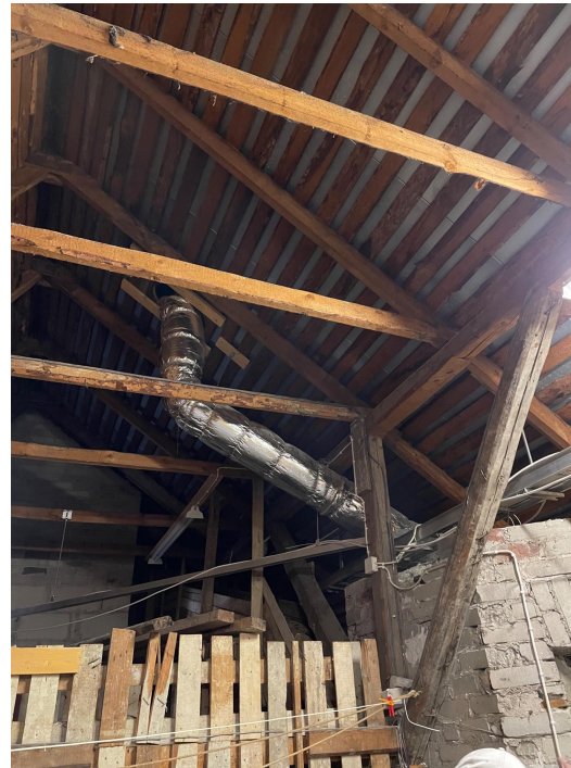
Porrashuoneen poistoilmakanava ullakolla. Hormit on myöhemmin, vuosien 2012-2013 linjasaneerauksen yhteydessä viety eristettynä ullakon läpi ulkoilmaan (As Oy Hauhon hallitus: Saarinen & Mattila), mikä saa porrashuoneen ilman kiertämään tehokkaammin.
