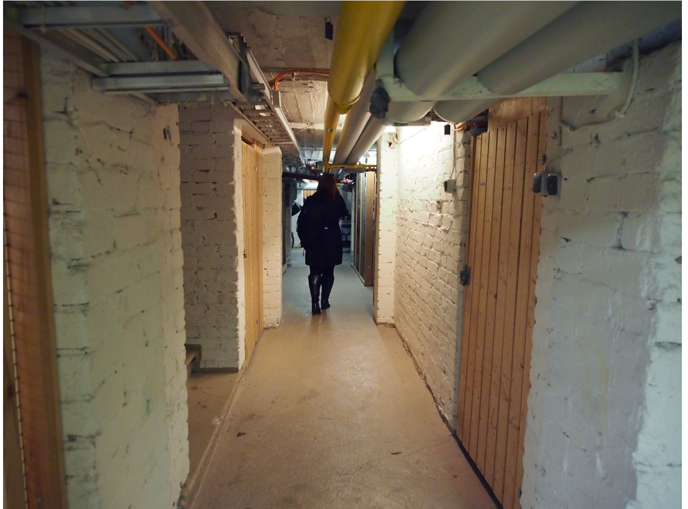
Kantavia tiiliseiniä 8 L kellarissa. Betonilattia peittää osittain alimman tiilirivin. Seinät on todennäköisesti muurattu ensin, minkä jälkeen on valettu betonilattia.
