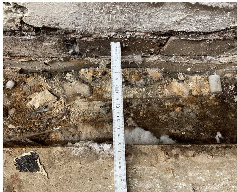
Lattiassa on 15 cm leveät raot seinän vieressä.
