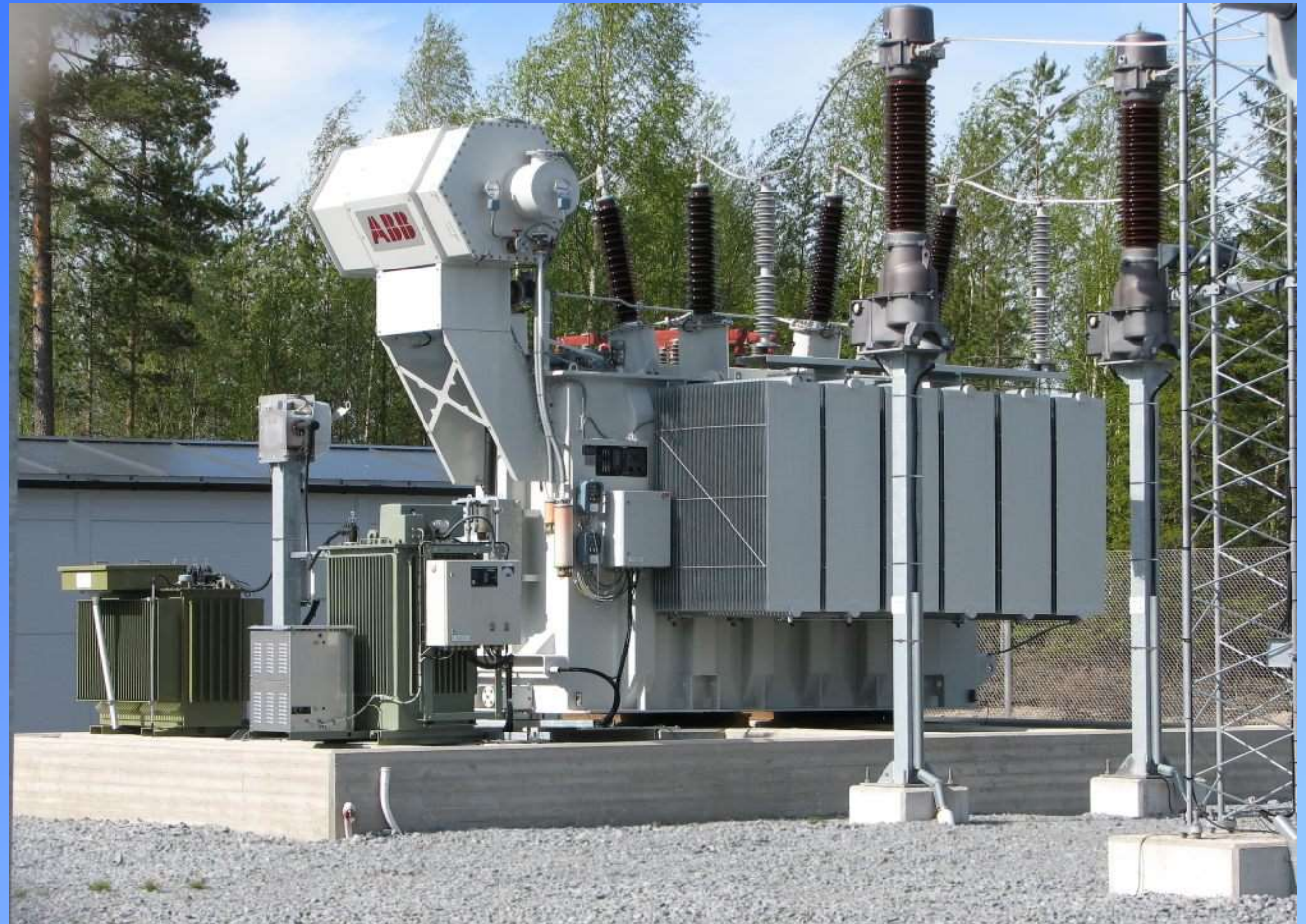
110 kV sähköaseman muuntaja
