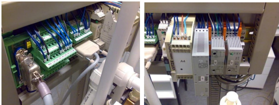
Kuva 3 KytKentäpaneeli, oikealla anturiin/toimilaitteeseen liittyvää elektroniikkaa
