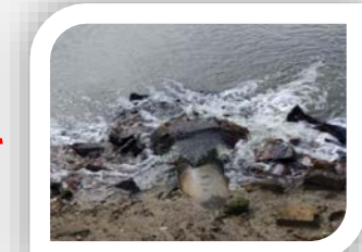
effluent for discharge or reuse
